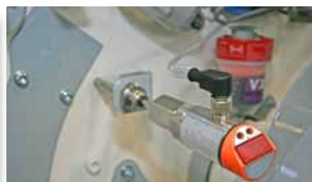
Contrôle de température sur chambre de broyage
